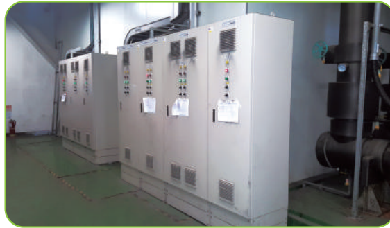
空調系統改善(冰機系統-冷卻水塔變頻)
