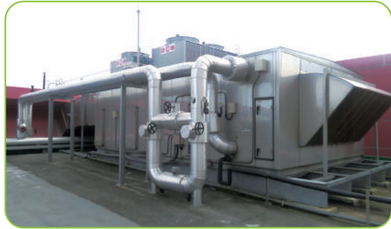
空調系統改善(設置外氣空調箱以減低冰水主機負荷)
