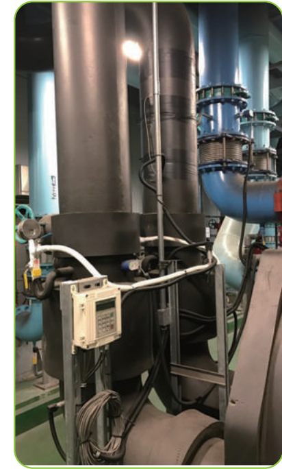
生產設備改善(空壓暨熱回收節能改善)
