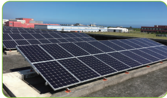
可再生能源改善(增設太陽能板)
