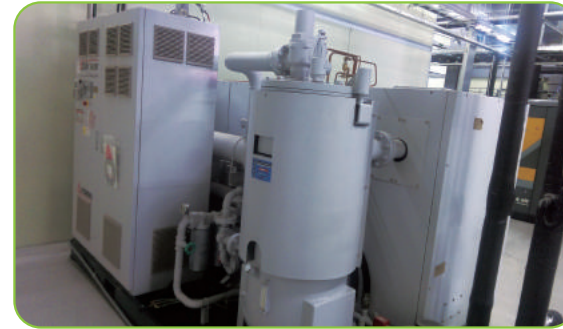
空調系統改善(更換變頻式空壓機)
