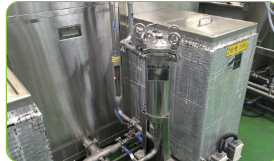
增設處理設備，提升用水循環次數(水洗槽以逆沖洗方式降低耗用水量及增加晶片潔淨度，原始供水再利用循環)
