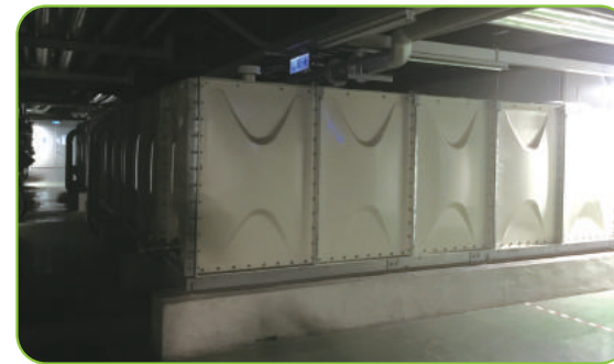
增設水回收系統(增設組合式水箱回收系統)
