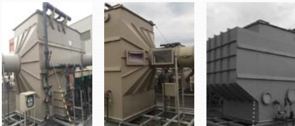
宜蘭三廠 新增洗滌塔
