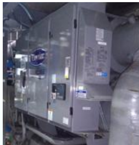
AC1+AC2 汰換變頻冰機
