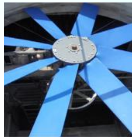
冷卻水塔鋁合扇葉改為 FRP 節能扇
