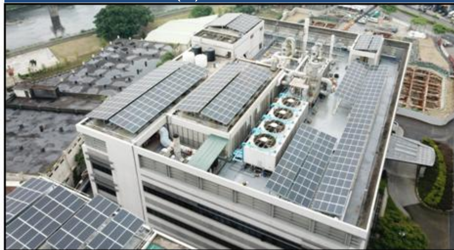
朋程科技(股)公司屋頂型太陽能案場
