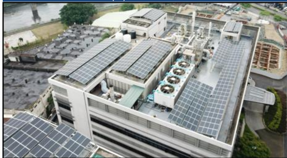
朋程科技(股)公司屋頂型太陽能案場
