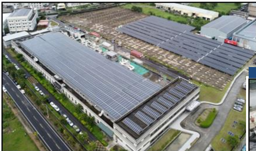
宜蘭廠屋頂型太陽能案場
