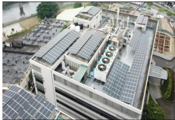
朋程科技(股)公司屋頂型太陽能案場
