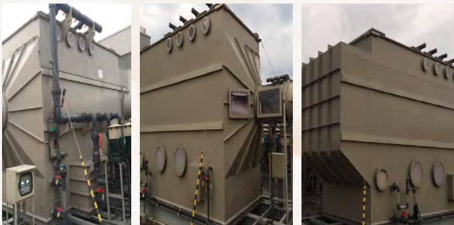
▲宜蘭分公司三廠 新增洗滌塔
