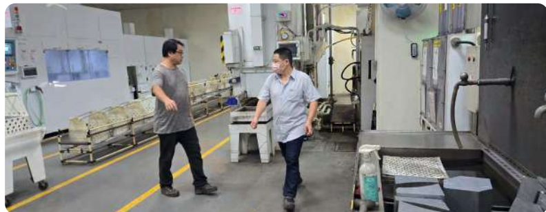
1. 人員發現酸洗機排酸管路洩漏，通報現場領班
